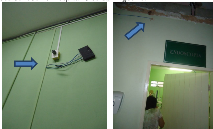
Figura 13 – Cabos de rede no Hospital Giselda Trigueiro.
