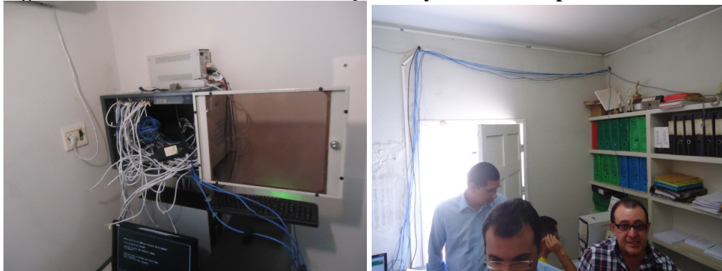
Figura 22 – Sala de Informática do Hospital Ruy Pereira / Hospital de Caraúbas
