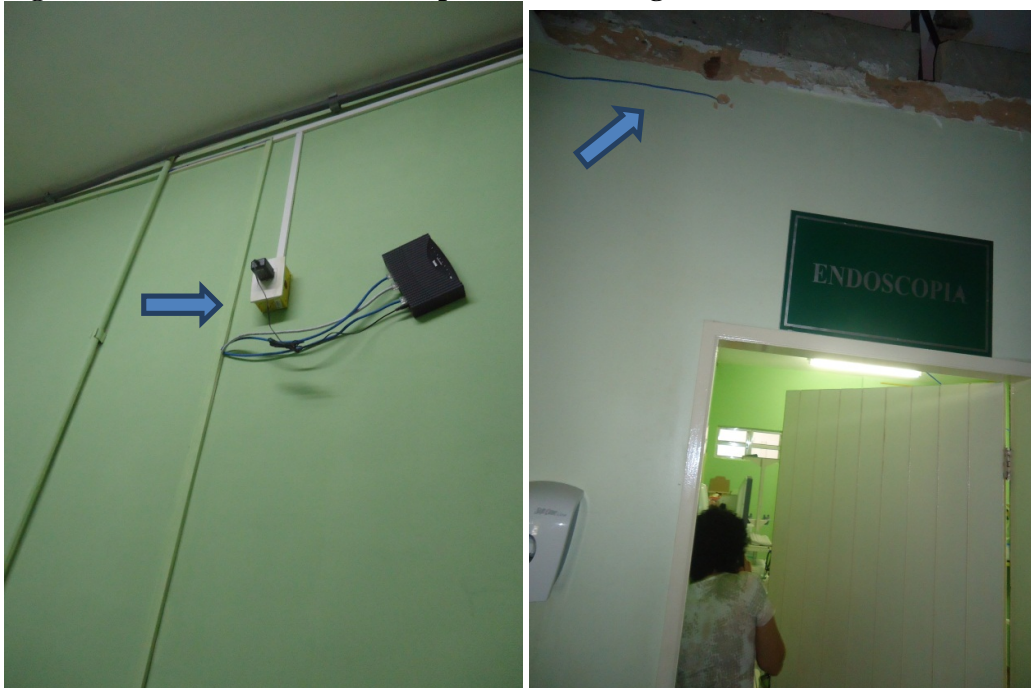
Figura 23 – Cabos de rede no Hospital Giselda Trigueiro
